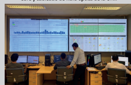
Oficinas del Centro de Operaciones de Redes (NOC) y del Centro de Operaciones de Ciberseguridad (SOC).
